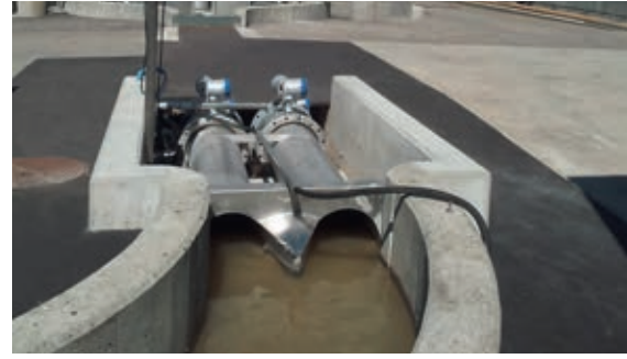
Tam dolu olmayan borularda atık suyun akış ölçümü
