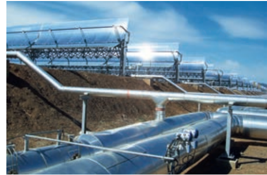
Konsantre bir güneş enerjisi santralinde termal yağ akış ölçümü
