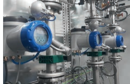
Yanma kontrolü için doğal gaz ve oksijenin akış ölçümü
