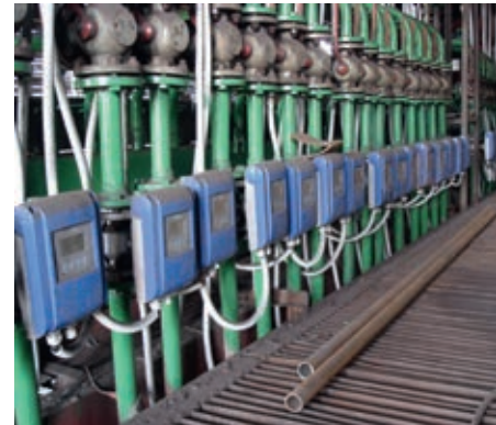
Tasfiye ocaklarının ve çelik fabrikalarının soğutma hatlarında sızıntı tespiti
